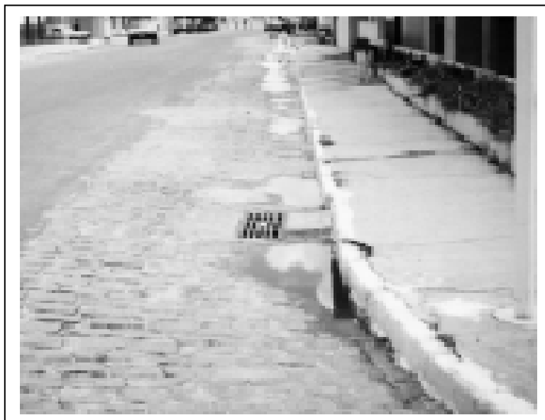
Figura 6.7 - Sarjetas acidentadas dificulta a limpeza e a drenagem
